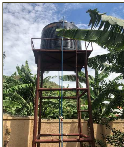
Bild: Wassertank neben der Station
