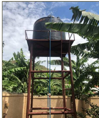
Bild: Wassertank bei der Station
